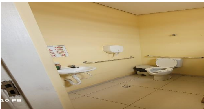
Banheiro adaptado para Pessoas Portadoras de Deficiência em operação
