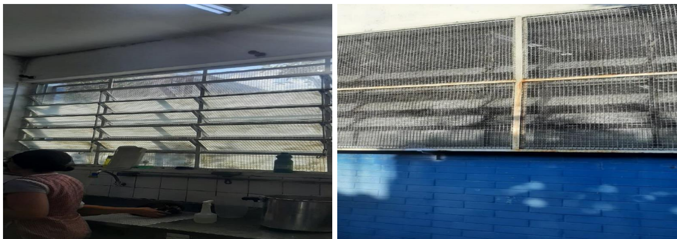
Tela milimetrada instalada
