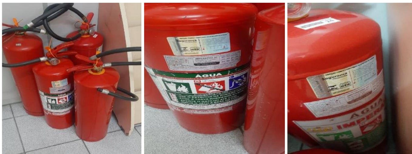
Extintores novos com prazos de validades até 2026 e 2027
