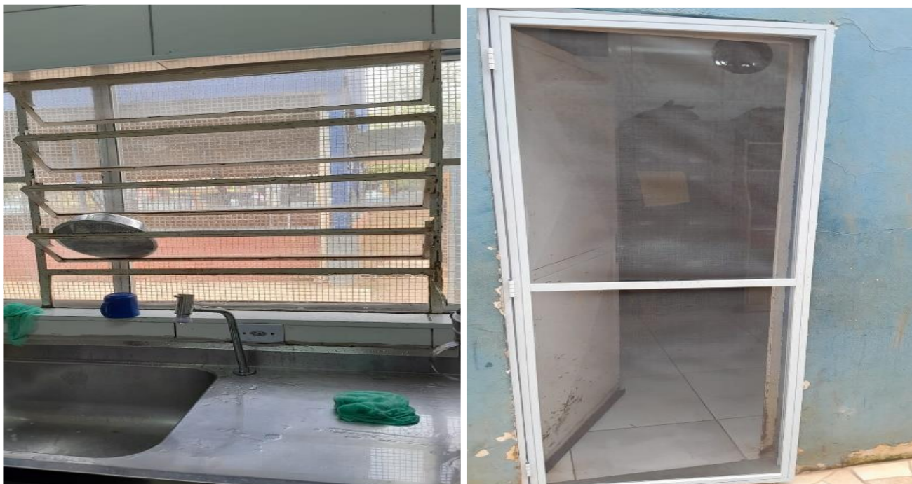
Tela milimetrada instalada
